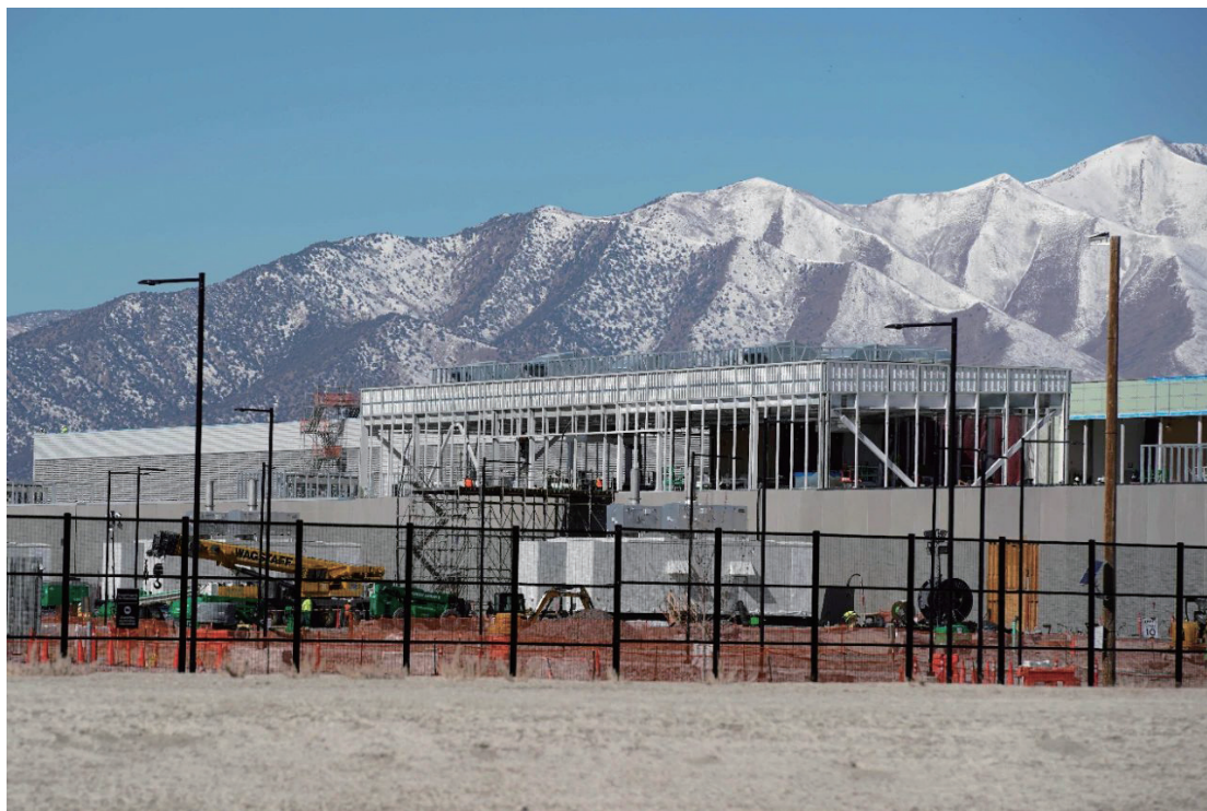
当地时间 2021 年 3 月 1 日，美国犹他州，“脸书”新数据中心坐落于一座雪山旁。因耗能巨大，互联网企业多将数据中心设在散热好的寒冷地区，甚至海底。（视觉中国/图）
